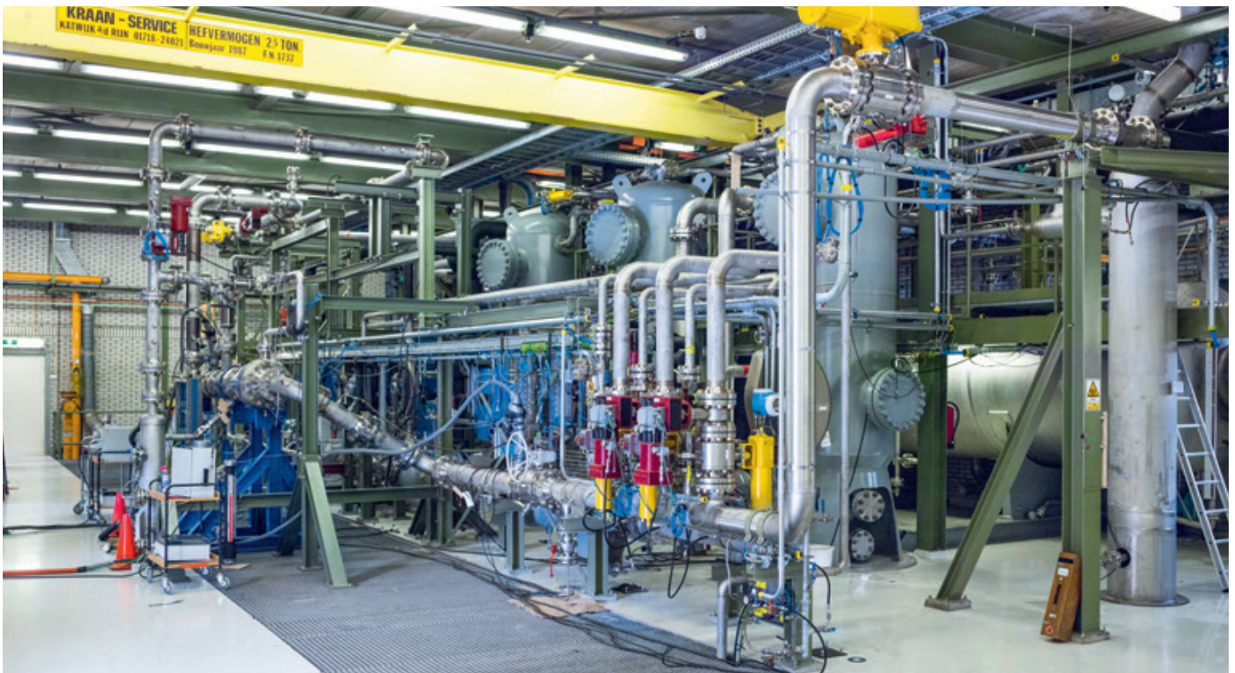
Testprüfstand für Wasserstoff in Groningen
