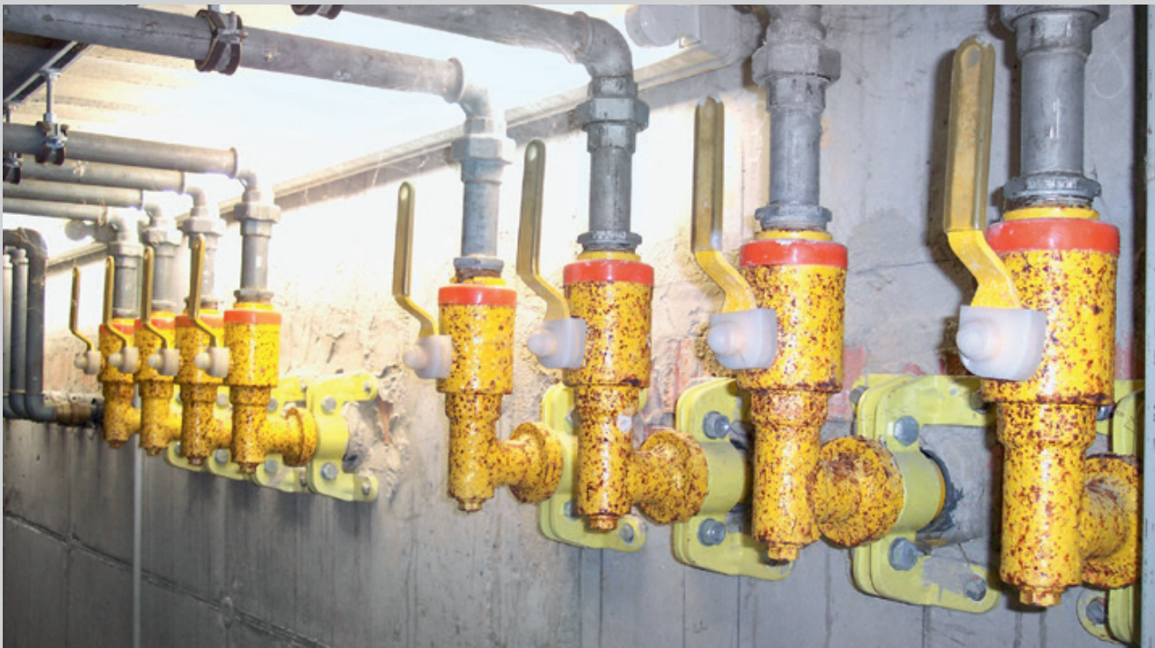
Gasnetzanschlüsse mit Sommersprossen trotz Lichtschutz (entdeckt von Roland Hannig)
