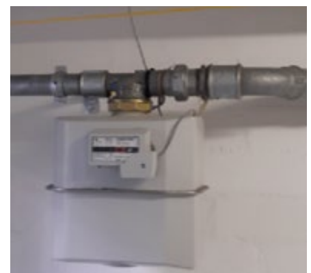
Zählerdatenübermittlung direkt auf das Verrechnungssystem von Energie Wasser
